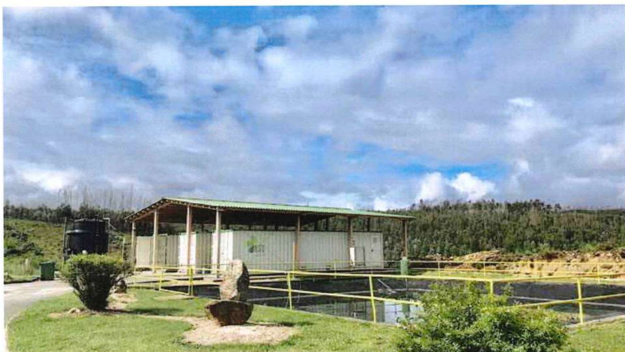
FIGURA 26 – Unidades de osmose inversa da ETAL do CTRSU e Tondela.
