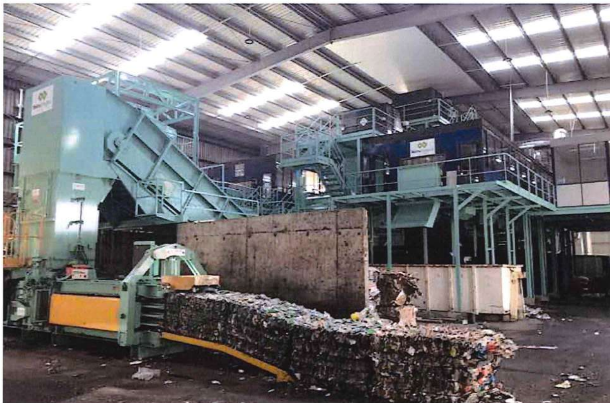
FIGURA 18 – Equipamentos da Central de Triagem de embalagens do CTRSU de Tondela intervencionados pelos investimentos de modernização e ampliação.
