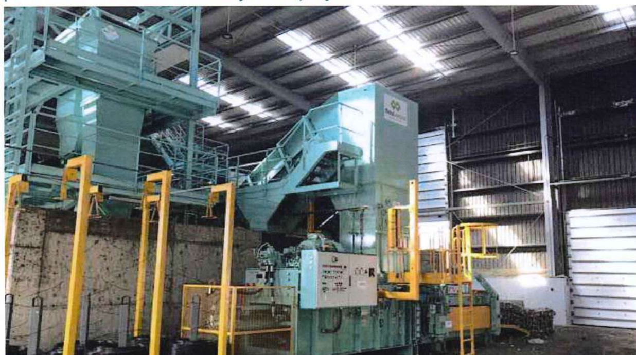
FIGURA 17 – Equipamentos da Central de Triagem de embalagens do CTRSU de Tondela intervencionados pelos investimentos de modernização e ampliação.
