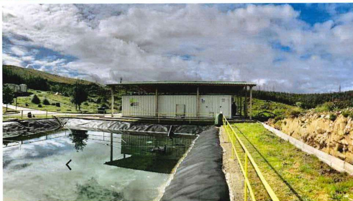
FIGURA 27 – Lagoa de permeado da ETAL do CTRSU de Tondela.
