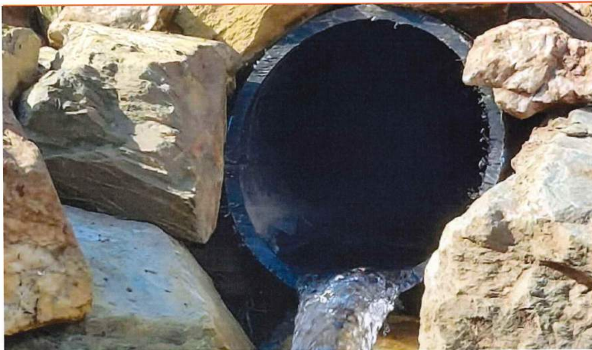
Figura 34 • Descarga da água tratada
